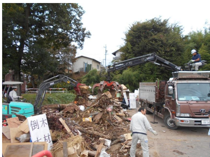
令和元年東日本台風(台風第19号)による市内の災害廃棄物(旧神川地区公民館)
