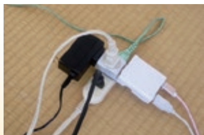
たこ足配線の状況
