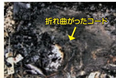
火災で焼けた、折れ曲がったコード
