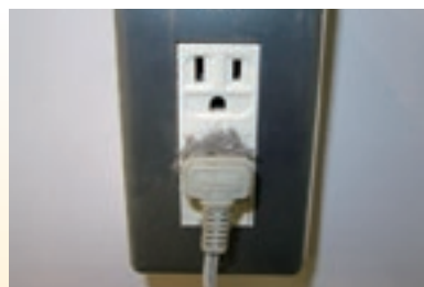
コンセントにほこりが溜まった状況
