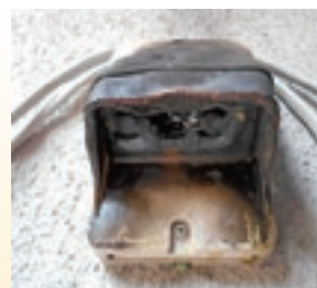
トラッキング現象による火災事例
