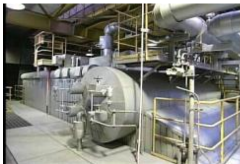
写真 2-6 ボイラー設備
