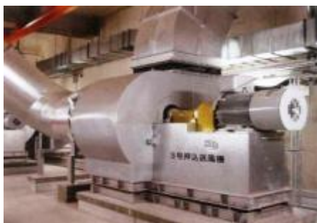
写真 2-9 一次押込送風機
