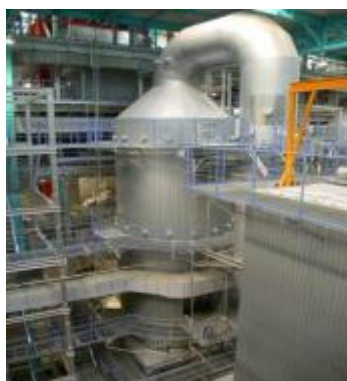
写真 2-7 排ガス冷却塔
