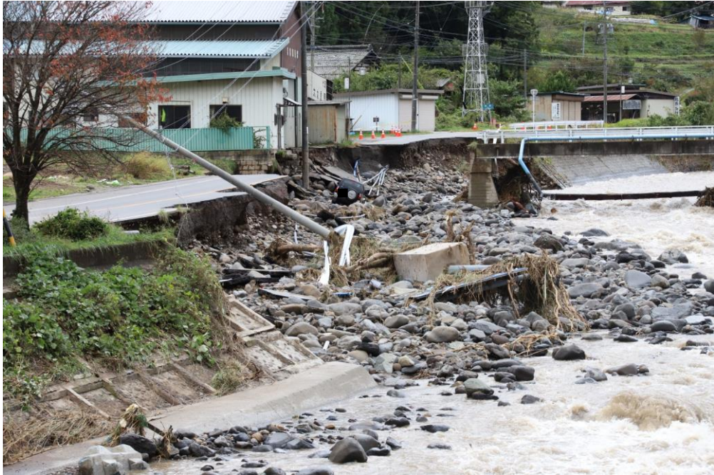
画像 11 長和町：「大和橋」 付近道路崩落（大門川右岸） 洗掘により道路が崩落し、走行中の車両が転落した。
