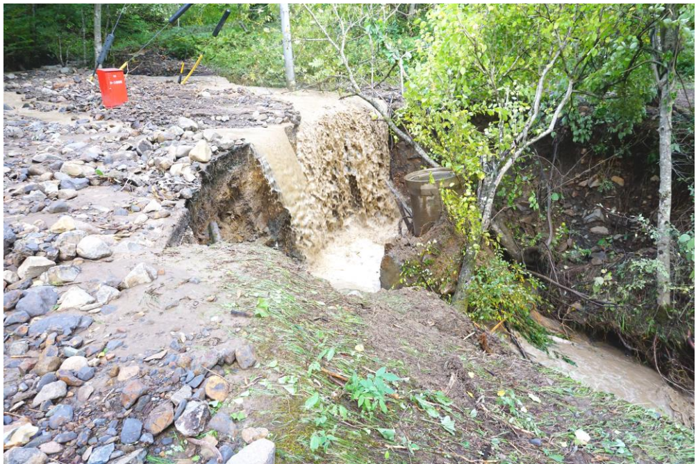
画像 12 青木村：「青木の森別荘地」 道路洗掘（青木村大字沓掛） 舗装された別荘地内の道路が洗掘され、見る影もなく破壊された。
